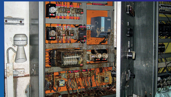
... in unserer Sprinkler-Zentrale, Gebäude 30
