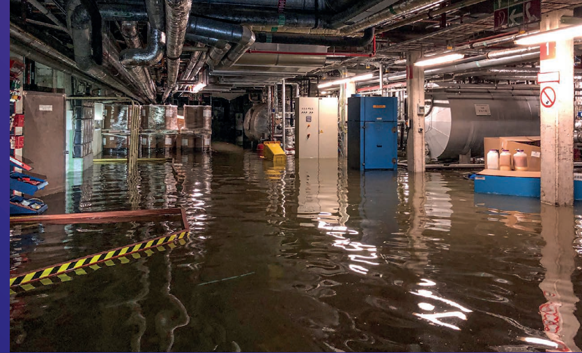
Unterirdische Zustände auch im Gebäude 61, M10...
