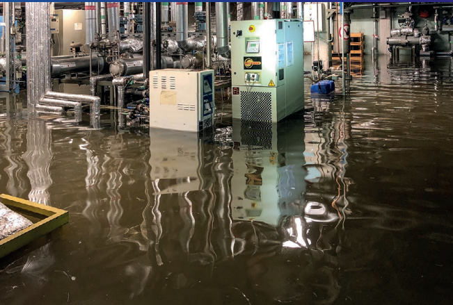
Die Wupper im Keller von Gebäude 61, M10 ...
