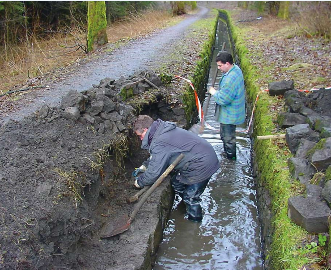
Bild 11 Die aktiven Anlagen werden systematisch kontrolliert. Jährlich werden etwa 1.000 m 2 Trockenmauerwerk neu gesetzt. Dazu kommen aufwändige Reparaturen an den Teichdichtungen.
